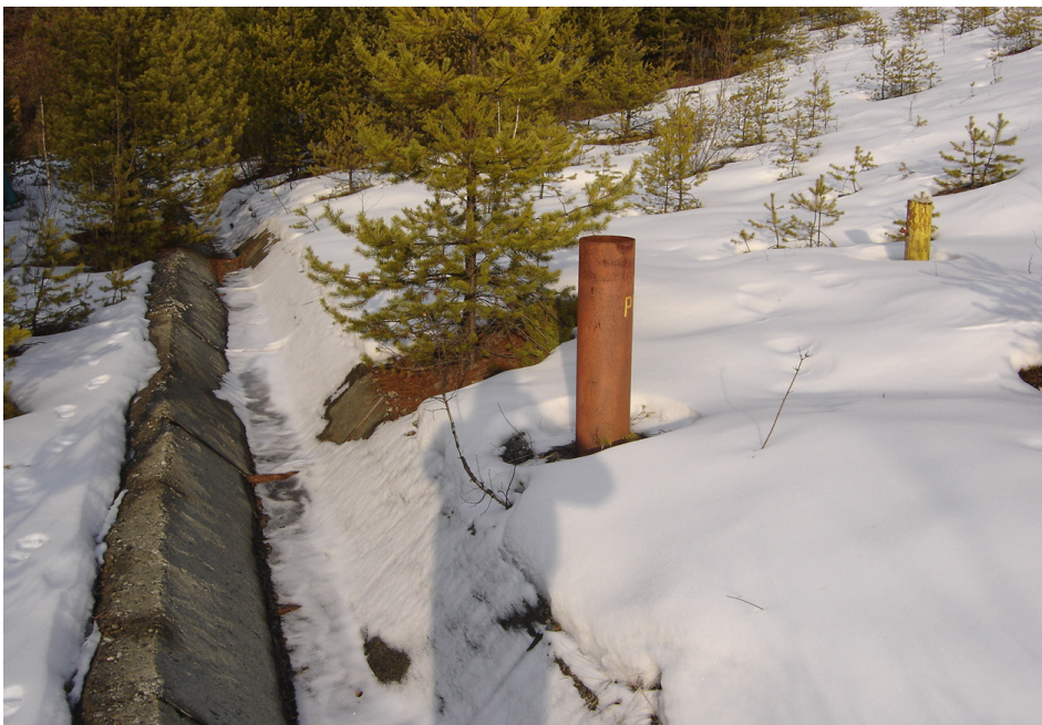
Obr. 10 Betónový odtokový žlab a prevažne nefunkčné monitorovacie sondy na hrádzi odkaliska
