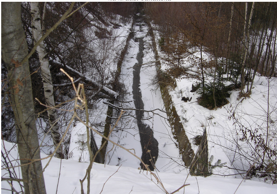
Obr. 11 Odtokové kamenné, resp. betónové žľaby sú lokálne zanesené naplavenou sutinou i deštruovanou betónovou zmesou
